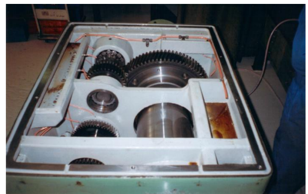
Bild 3: Gute Konstruktion. Von oben ist der Deckel abnehmbar. Der Spindelstockschaden zeigte einen Lagerschaden. Er muss geöffnet werden. Dazu wurde der Spindelstock in unsere Werkstatt genommen.
