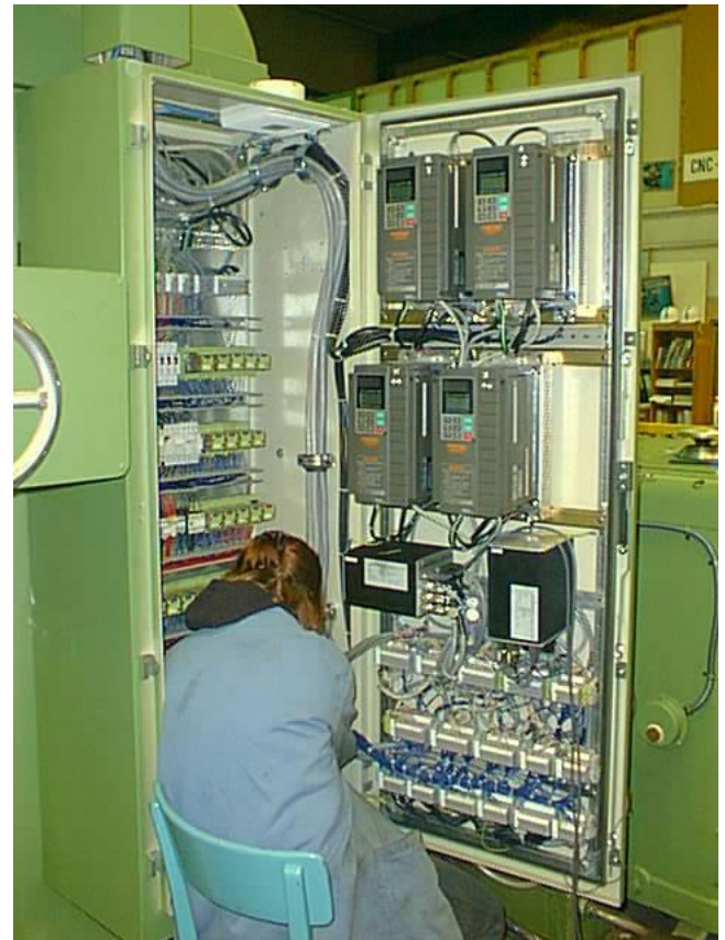
Bild 25: Elektroschrank Montage der Waldrich Hobelmaschine. Schrank direkt an der Maschine angebaut.
