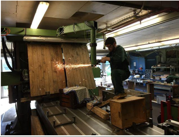
Bild 10: Hier musste das CNC Halterohr noch etwas gekürzt werden, damit das Werkstück unter der Steuerung durchfahren kann. Eine gute Abdeckung ist wichtig, dass nichts beschädigt wird.
