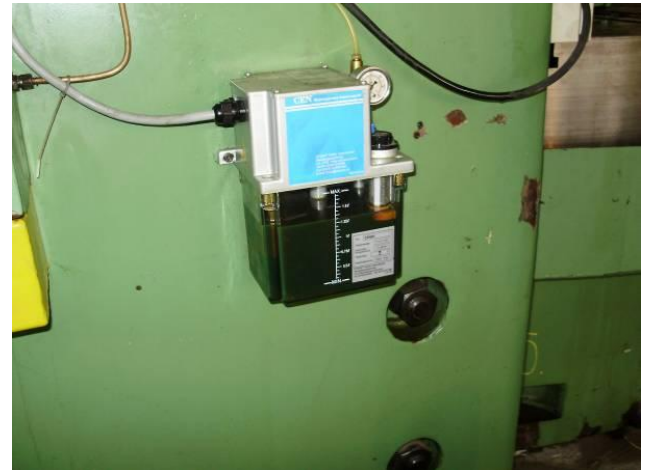
Bild 38: Der Anbau einer automatischen Schmierung. Die Schmierpumpe haben wir auch noch einmal erneuert mit Druckschalter und Niveauschalter, so dass Druckleitungsfehler an der Steuerung erkannt werden.
