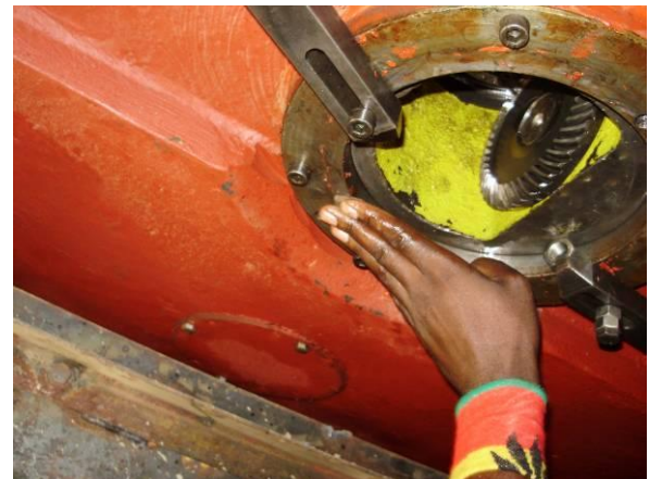
Bild 33: Das Kegelrad, das mit Distanzringen nach oben gedrückt wird, damit es spielarm war.
