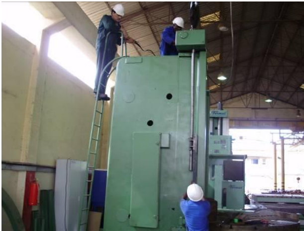
Bild 14: Die Maschinen Leiter ist montiert. Eine gute Sache, weil doch auch Motoren und Spindeln da oben angesteuert werden. Es ist alles Fingerspitzengefühlarbeit und einiges voraus denken ist nötig. Viele Schrauben fehlten, mussten noch organisiert werden.
