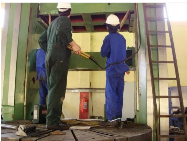
Bild 10: Hier halten 2 Männer mit 2 Hölzer entgegen, damit das Dach nicht pendelt. Finger in der Nähe sind gefährdet .
