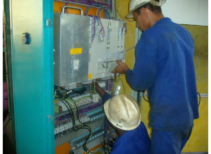
Bild 3: Der ganze Spindelantrieb wird ersetzt, weil keine Ersatzteilgewährleistung mehr da war von Siemens. Und in Angola gibt es ab und zu einen Knall. Dabei entstehen Zehntausende Franken Defekte durch das Kondenswasser das sich bildet, wenn einmal eine Trafo der Stromversorgung aussteigt und mehrere Stunden die Elektroschränke abkühlen. Jetzt hat man ein norm Motor 30 KW genommen der weniger empfindlich ist und ein FU.
