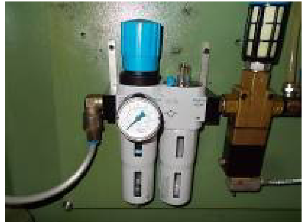
Die Wartungseinheit bei der Speisung hat eine grosse Menge Luft durch Undichtheit verloren. Diese wurde ersetzt. WU5130d
