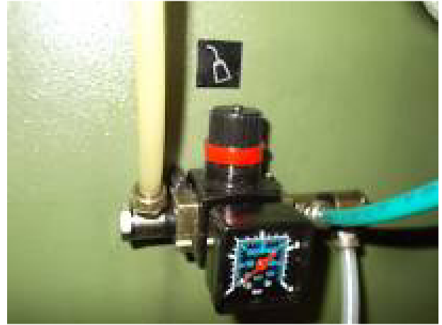
Eine sogenannte Ölnebel Schmierung sorgt dafür, dass die Zylinder, der Drehtisch und die Bohreinheiten mit Ölnebel versorgt werden. WU5130c
