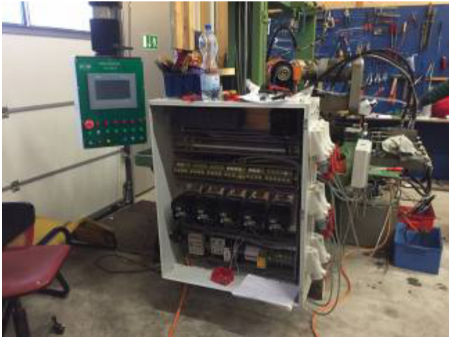
Einspeisung unten links. WU5140d
