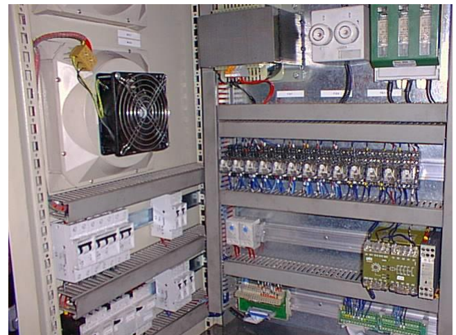
Bild 32: Fertiger Elektroschrank für die revidierte umgebaute MFD Walzendrehmaschine WDK 850 mit 220 Spindeltrieb.
