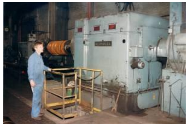
Bild 2: Die Maschine hat ein Spindeltrieb mit 220 KW. Die ganze Elektrik wurde von uns erneuert inkl. des Spindeltriebs.
