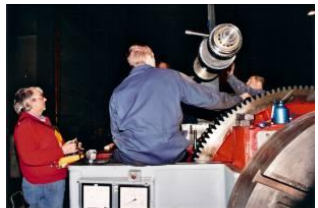
Bild 29: Der Einbau funktionierte sehr gut. Das Getriebe der MFD, Hut ab, wir können die Hersteller nur loben. Sensationell, wie die ganze Konstruktion von oben zugänglich gemacht wurde. Perfekt, danke an MFD, das ist eine der besten Maschinen, die wir je gesehen haben.
