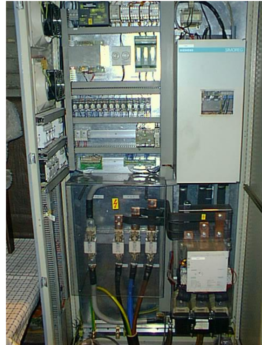
Bild 31: Neuer Elektroschrank für die 220 KW Kopierdrehmaschine
