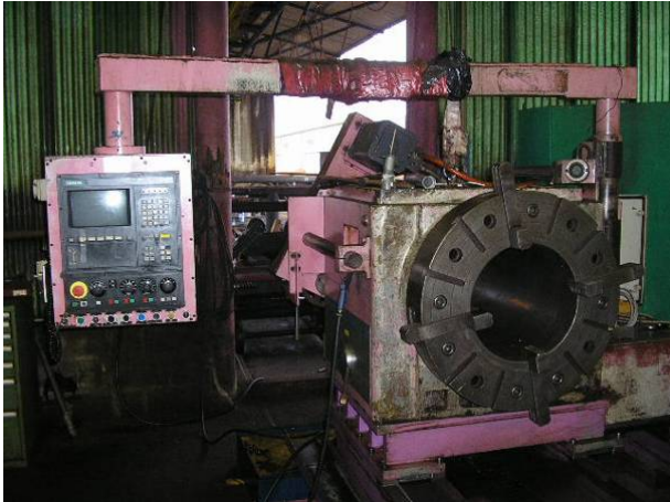
Photo 1: Maschine läuft seit einigen Tagen nicht mehr. Spindelantrieb geht nicht. Def. Entscheid sofort die CNC ersetzen.
