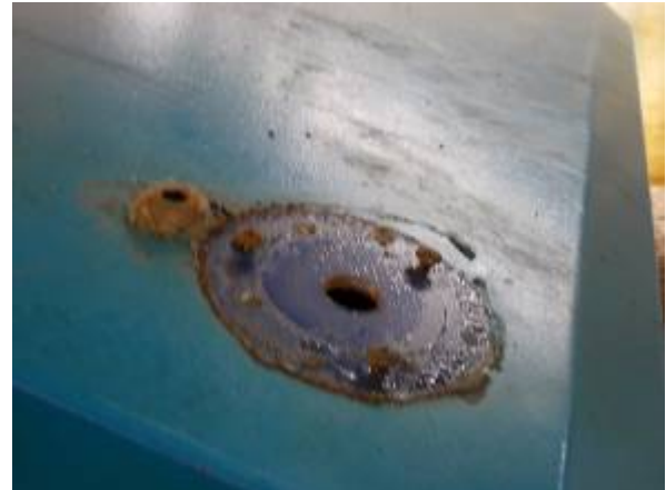
Bild 1: Hier war eine Lampe. Oben, wo die Schraube ist, war ein Loch, über welches beim undichten Dach durch einen Sturm, die CNC Steuerung Fanuc 18 i zerstört wurde. WU_232_10
