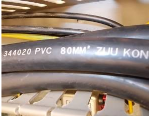
Bild 26: Kabel mit 80 mm 2 . Da die Maschine im Herkunftsland mit 115/220 Volt betrieben wird, sind diese dicken Kabel erforderlich. WU_232_200
