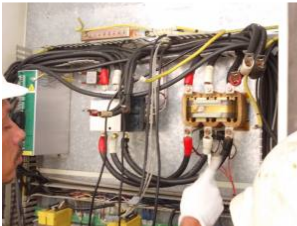
Bild 7: Dicke Kabel sind hier im Einsatz. Das dickste ist 80 mm 2 . Da Japan, wie die USA, mit tieferer Spannung arbeitet, sind alle Kabel Querschnitte mehr als doppelt so dick wie bei uns. WU_232_70
