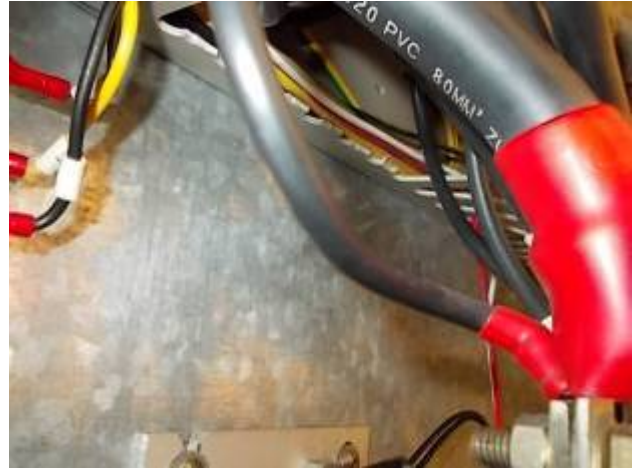
Bild 28: Vorne 80 mm 2 ; hinten 10 mm 2 . Unsicher schliessen wir den 10 mm 2 direkt an einer Sicherung an. WU_232_220
