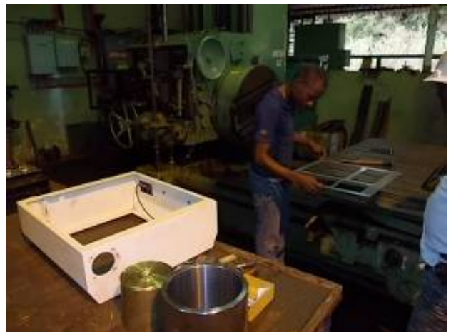
Bild 21: Panelumbau in Vorbereitung. Die alte Fanuc wurde hier demontiert und wir bauen hier die neue Sinumerik 802 DSL rein. WU_232_150
