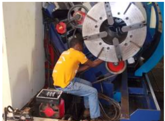
Bild 13: Der von uns ausgebildete Unterhaltschef Yoba Casimiro beim Hauptmotor Ausbau. Er entfernt die V-Riemen vom alten Fanuc Motor. WU_232_130
