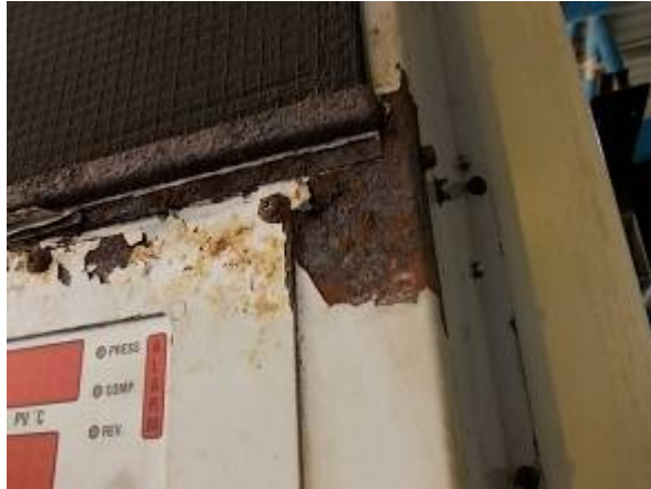
Bild 2: Bedingt durch das Klima in Angola sehen die billig gebauten Geräte in 2 Jahren so aus. Gut zu erkennen, aus welchen Ländern bessere und aus welchen Ländern, schlechtere Qualität kommt. WU_232_20
