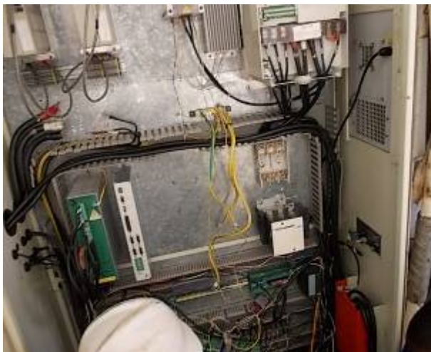
Bild 31: Bald ist alles schön eingebaut und es hat noch ein wenig Reserve Platz. WU_232_250
