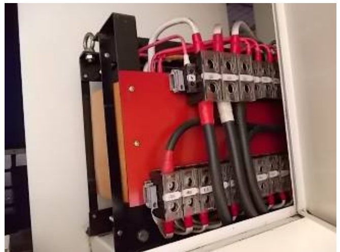
Bild 29: Ein grosser Transformator, der die 230/400 Volt auf 115/220 Volt reduziert. WU_232_230
