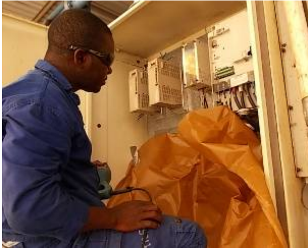
Bild 30: Wir mussten den Jungen erklären, wenn sie beim Bohren nicht abdecken, kann es beim Einschalten einen Knall geben. Darum muss immer alles abgedeckt sein, wenn gebohrt wird. WU_232_240
