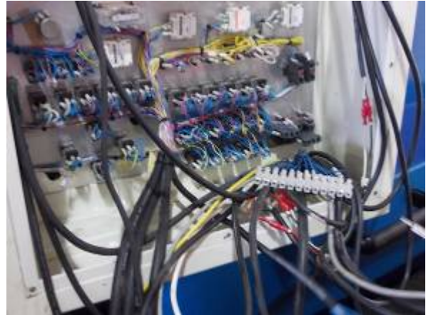
Bild 4: Hier die Innenansicht vom alten Panel. Auffallend ist, dass mit einem 50-poligen Kabel die CNC verbunden wird. Wir ersetzen dies mit einem 2-poligem Profibus Kabel. WU_232_40
