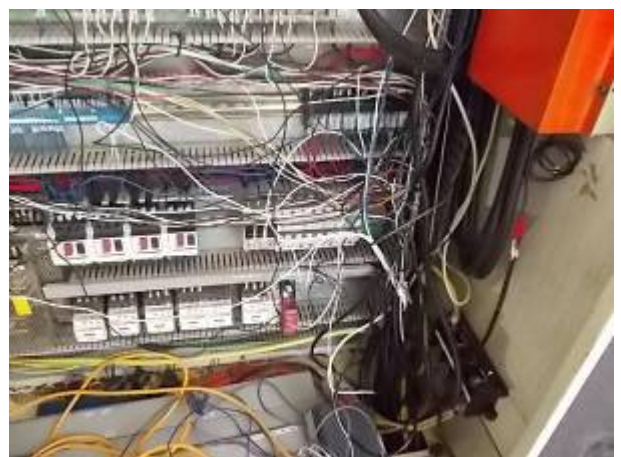
Bild 9: Gemischte Kabelvernetzung. Auffallend ist, der Maschinenhersteller hat für die 220 Volt den 0 Leiter und die Speisung mit diversen Farben verdrahtet. Kabel, die zu kurz waren, wurden im Elektroschrank mit Kabeln mit verschiedenen Kabel Farben verlängert. Erkennbar, die Qualitätssicherung für Maschinen nach Afrika ist nicht sehr gut. WU_232_90
