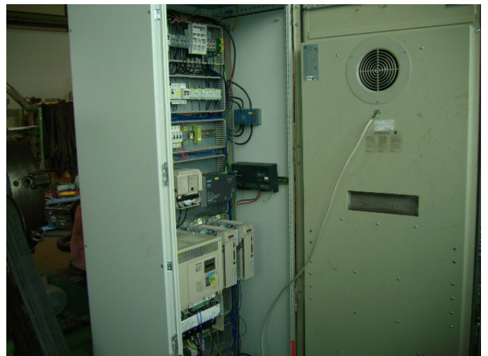
Bild 23: Nach Angola liefern wir nur noch klimatisierte Elektroschränke. Das schlimmste ist das Kondenswasser. Wenn die Anlage läuft, kein Problem. Gibt es einen Stromunterbruch ist, nach ca. 8 Stunden, alles voll Wasser im Schrank und nicht selten zerstört es die Elektronik. Auch Heizungen sind nötig, wenn in der Nacht die Temperatur dermaßen absinkt und am Tag die hohe Luftfeuchtigkeit. Die WIAP hat hier schon viele Stunden in Untersuchungen investiert für Zonen direkt am Meer in Tropengebiet. WU_260_150
