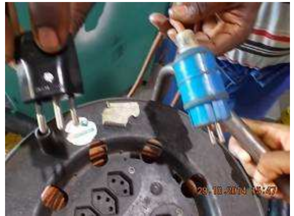
P48a) Viele Kabelrollen bei der Alcoa haben die Schweizer Stecker. Diese sind ausgelegt für 10 Amp. Jetzt werden bei vielen die Stecker abgeschnitten und neue montiert. Doch diese sind für 16 Amp. Nun verbrennen in der Regel die Buchsen in den Kabelrollen.
