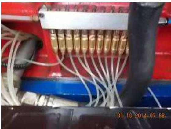
P13) Das alte, vorhandene Schmiersystem hat keine Druckkontrolle, dadurch konnte ein Schmierunterbruch nicht erkannt werden.
