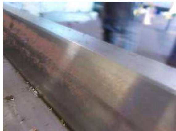
P73) Der Rost ist ein grosses Problem in Angola.
