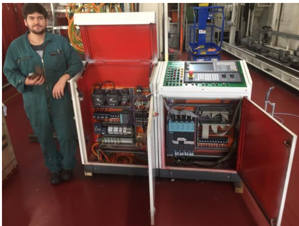
Bild 6.7. In der linken Schrankhälfte sind 3 Frequenzumformer angebracht
