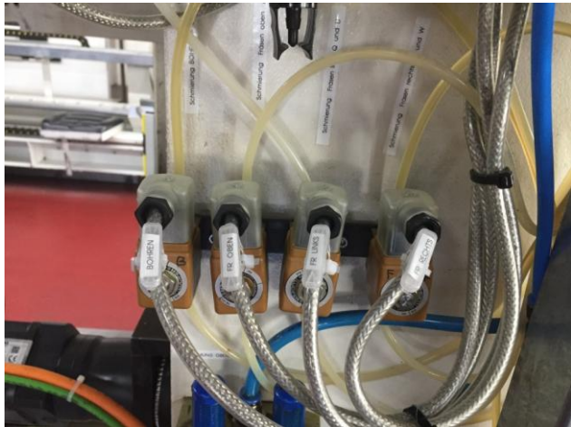
Bild 6.1: Am Hinterbalken der Maschine wurden 4 Ventile angebracht, dass die Schmierung pro Gruppe Einzel angesteuert werden kann.
